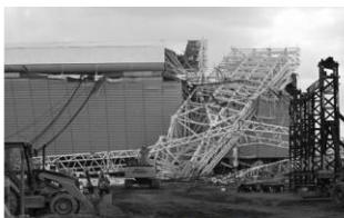
圣保罗市伊塔盖拉球场坍塌现场
